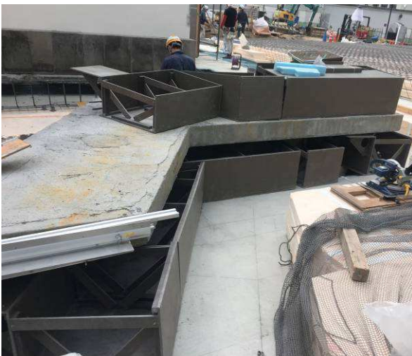
免震リフレフランターは全てつながっている。 エンドレスフランター構造。
